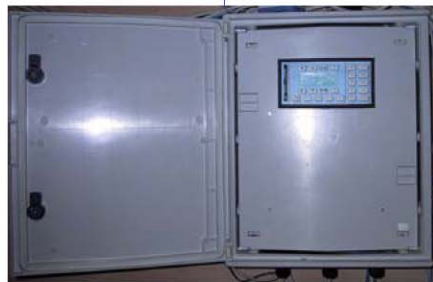
Unità di acquisizione dati mod. EL6200
