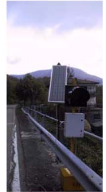
Sistema allarme con semaforo
