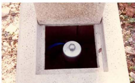
Pozzetto per una catena inclinometrica
